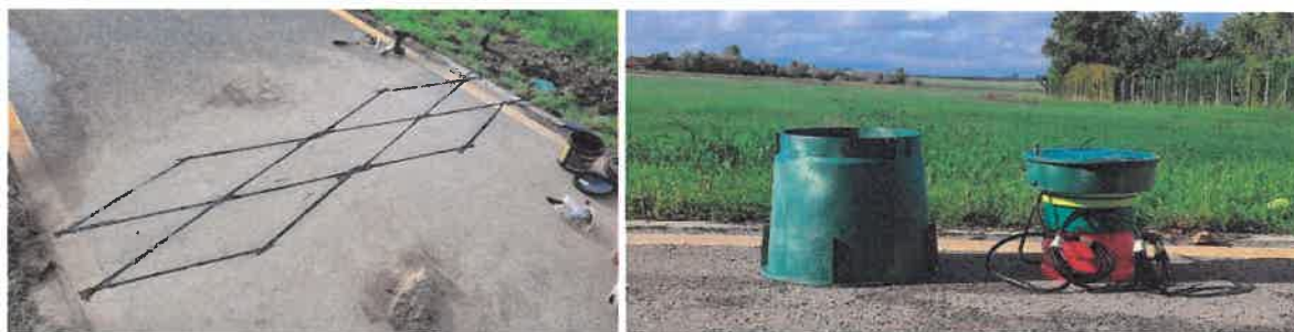
Figura 195: Buclă de inducție proaspăt instalată în pavajul unei piste de biciclete și componentele electronice ascunse în subteran (sursa: Eco-Counter)
