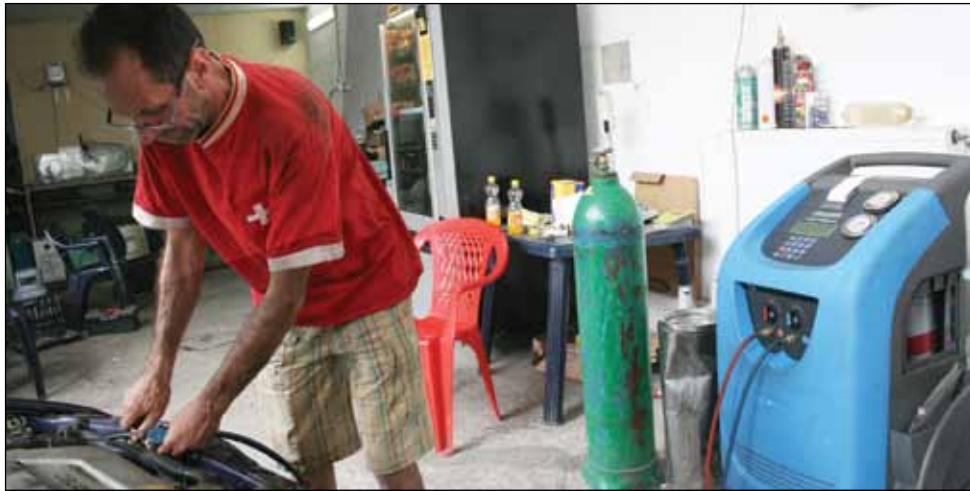
Cea mai uzuală operațiune este completarea instalației de climatizare cu freon
