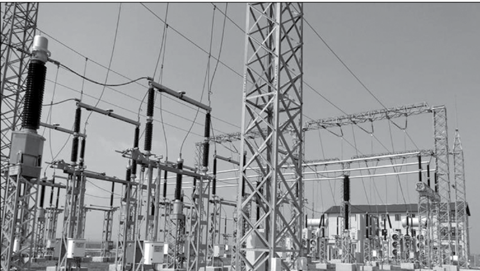
Stația de transformare deținută de Aton este una dintre cele mai moderne din țară
