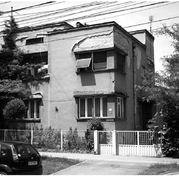
Vasile Tărciatu ar putea fi evacuat din clădirea în care stă
